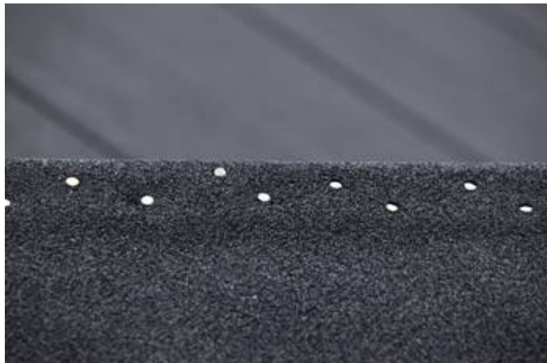
Die Unterlagsbahn wurde nach Vorgabe der DIN 1055 Teil 4 aufgenagelt. Quelle: Oliver Kern Fotografie
