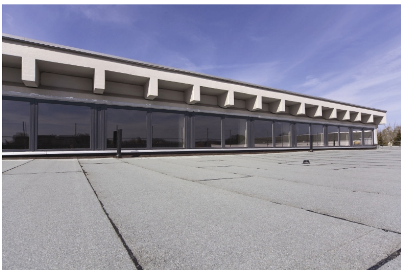
Das Dach der Realschule Bad Königshofen nach der energetischen Sanierung. Quelle: Vedag GmbH
