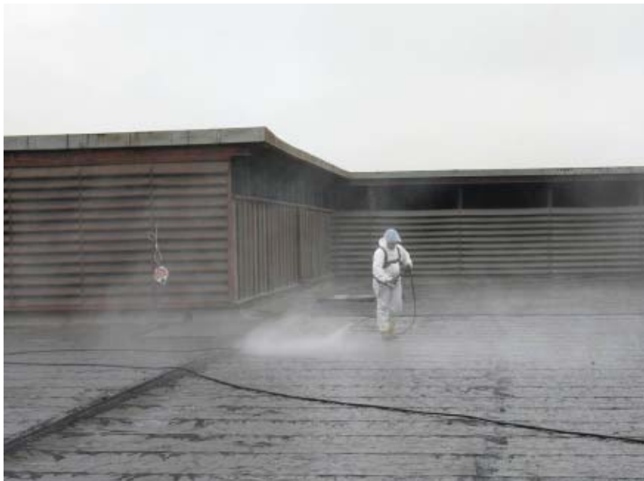
Die stark verkrusteten „Altflächen“ mussten vorab einer intensiven Reinigung unterzogen werden. Quelle: VEDAG GmbH
