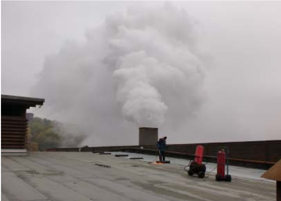
Bei laufender Produktion im Stahlwerk wird die Oberlage VEDATOP DUO dolomitgrau- Broof(t3) aufgeschweißt. Quelle: VEDAG GmbH
